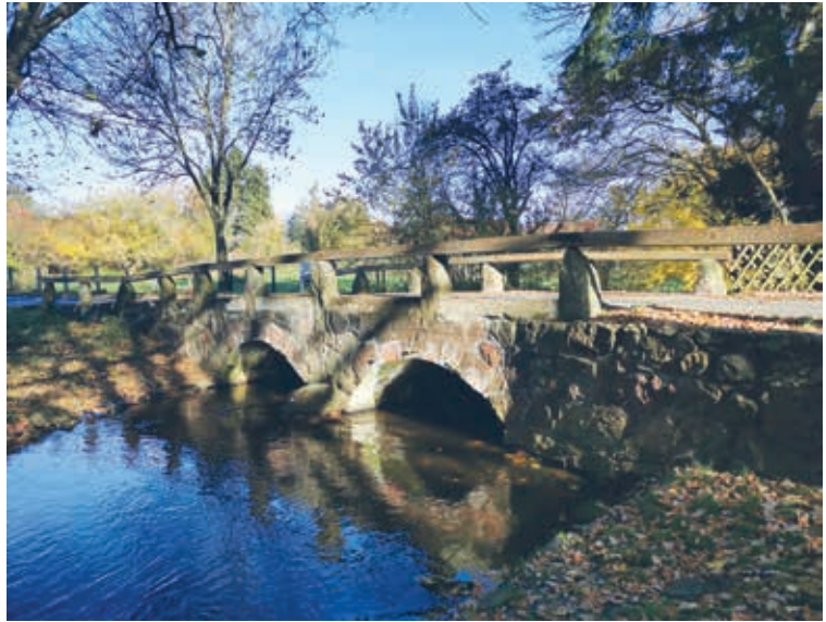
Abb. 11 Die sogenannte Napoleonbrücke über die Hardau in Holxen, Gemeinde Suderburg. Zustand November 2021. Foto des Verfassers.
