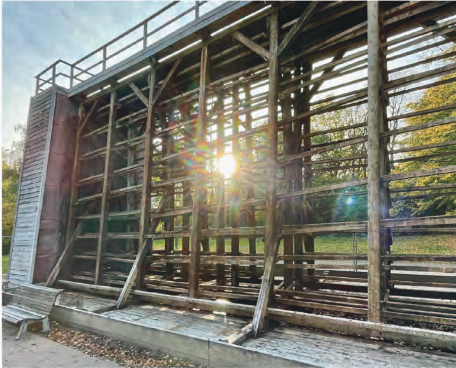
Abb. 9c Nur noch Ruine – das Gradierwerk 2022
